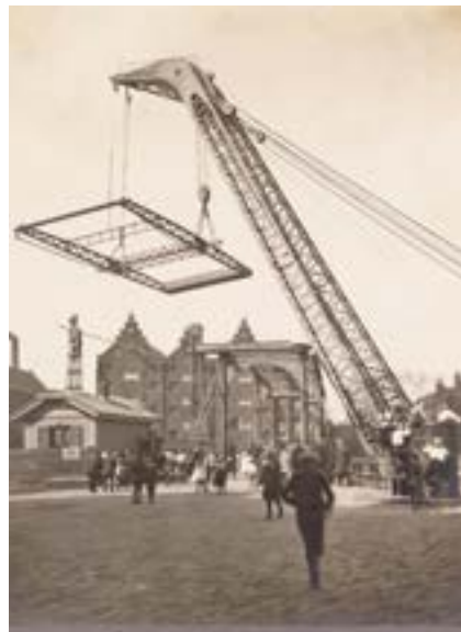
Nieuwe ophaalbrug over het Westerkanaal ter hoogte van de Westerkeersluis door de Firma Werkspoor Amsterdam. Op de achtergrond pakhuizen aan de Houtmankade, rechts de oude, dubbele ophaalbrug, 1919. SAA, Collectie Richardus, af. 010003025157.
